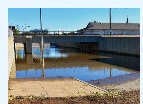
写真2: 冠水したアンダーパス (イメージ)
